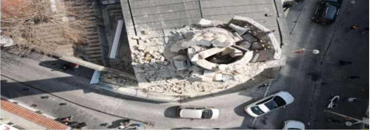
Resim-11 Gaziantep Karagöz Camii'nin 6 Şubat Depremden Sonraki Hali Dron Görüntüsü
