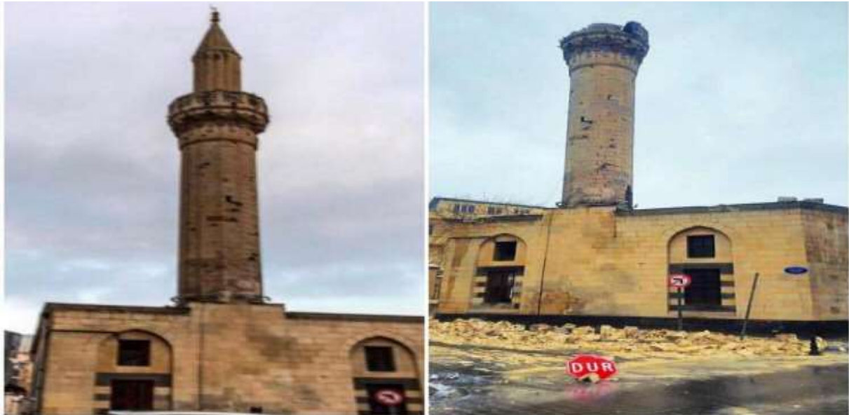
Resim-10 Gaziantep Karagöz Camii'nin 6 Şubat Depremden Önceki ve Sonraki Hali
